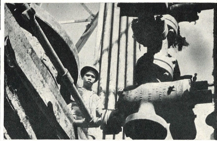
EEN Z.G. „CHRISTMASTREE“ (SAMENSTEL VAN AFSLUITERS EN VERBINDINGSSTUKKEN) WORDT OP EEN BORING TE LIMAU GEPLAATST.
